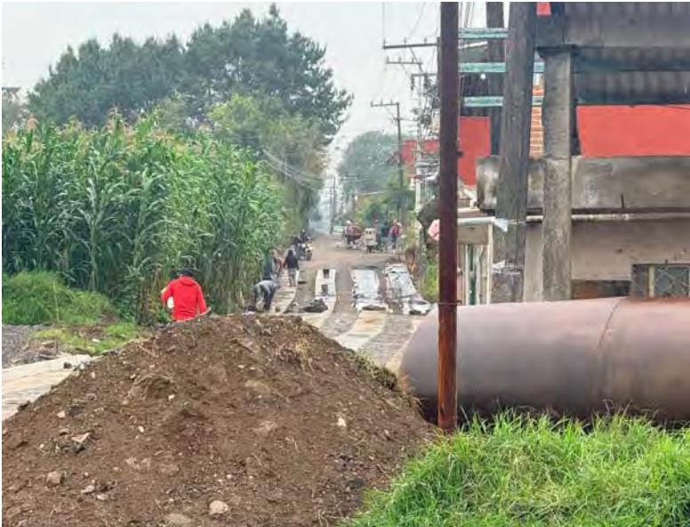
Vecinos de la comunidad de Zitalapa señalaran que la pavimentación de la calle 5 de Mayo se realizó sin contar con los permisos y la infraestructura básica de drenaje.
